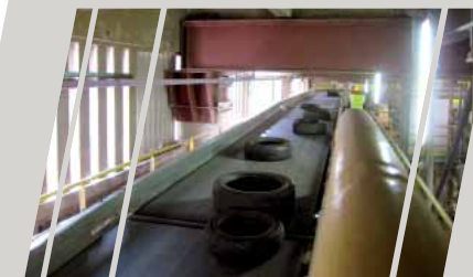
▲ Alimentation d'un four de cimenterie avec des pneus entiers.
